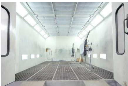
Cabine d'aspiration fermée et ventilée
